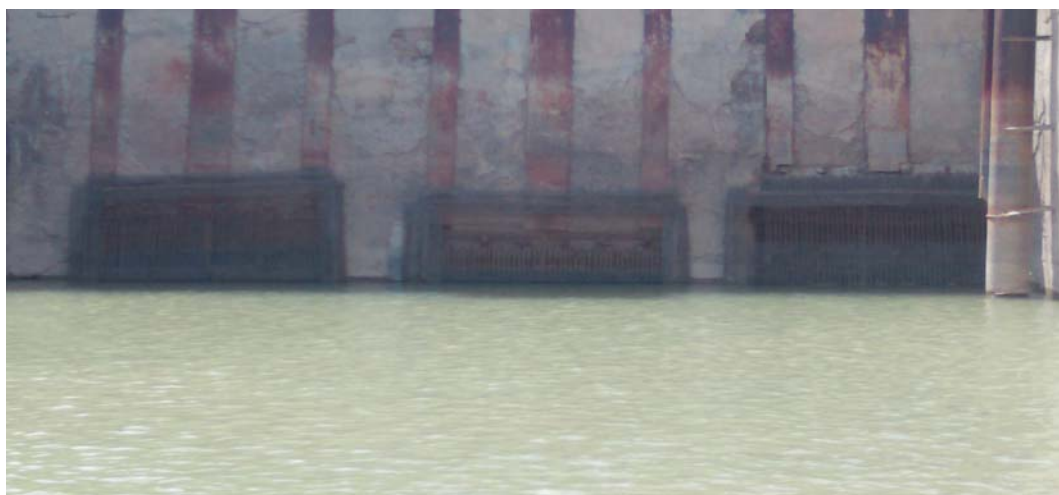
Рисунок 1 – Рыбозащитное устройство на ГУП «Горводоканал»
